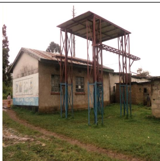
Changara CPC Solar charging Panels (Bungoma DBSC)
